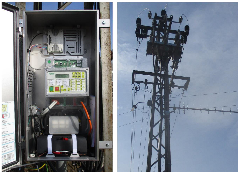
Slika 2 – Primer ugradnje PDR na reklozeru
