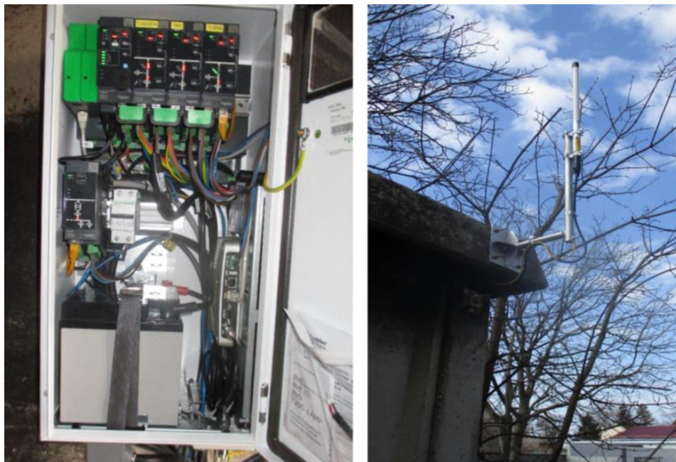
Slika 1 – Primer ugradnje PDR na distributivnoj trafo stanici
